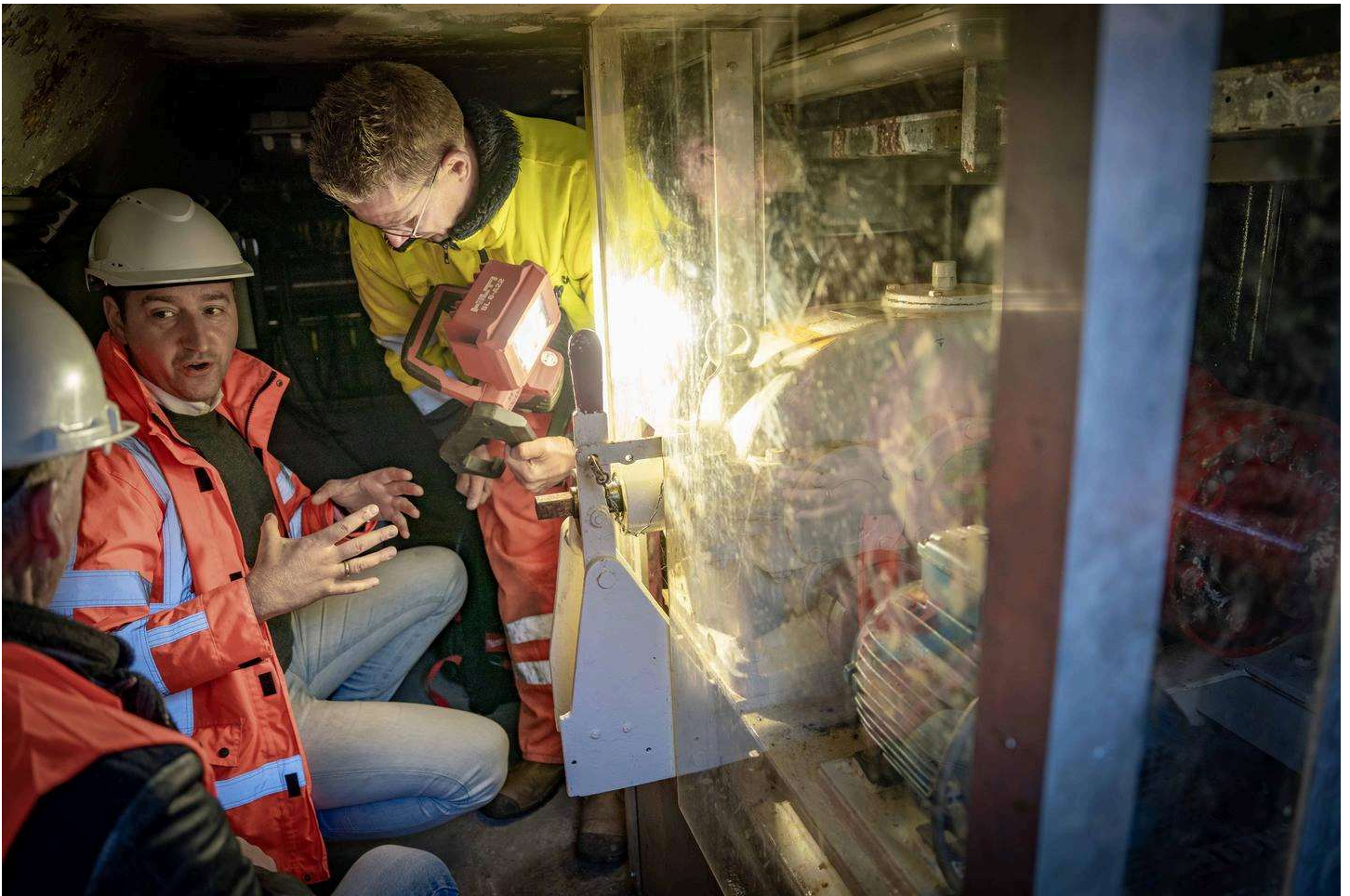
In de brugkelder aan de westkant zit behalve een handbediening ook de nodige elektronica verborgen. © Foto Redmouse
